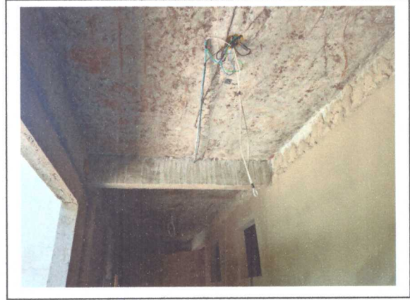
PONTO DE ILUMINAÇÃO NO TETO
