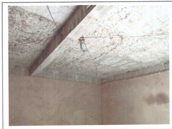
PONTO DE ILUMINAÇÃO NO TETO
